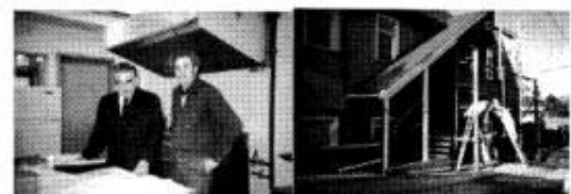
Építkezés utolsó fázisai 1984-ben: a konyha kialakítása. Alsó kép: Ft. Dr. Dóka Kálmán és Szendrey János terveket szemlélik az új konyhában The last stages of the renovation in 1984
